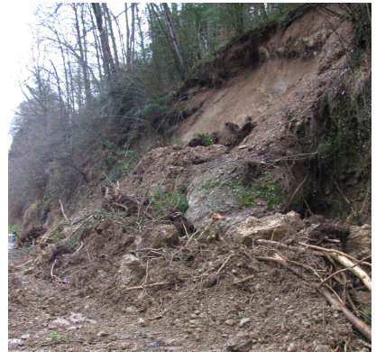
Les glissements de talus sont fréquemment observés après de fortes intempéries (photo non-représentative du territoire)
